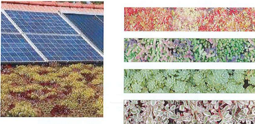
Panneaux photovoltaïques & Toitures végétales
