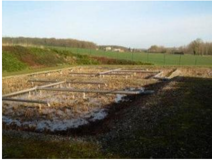
Station d'épuration à Cottenchy
